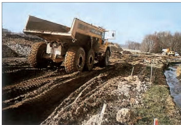
Cas typique d'une PST n°0 impropre à la mise en oeuvre d'une couche de forme
