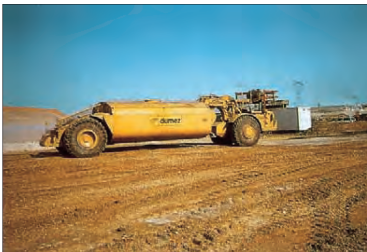
L'humidification des sols trop secs nécessite d'approvisionner de grandes quantités d'eau (souvent plus de 100 litres d'eau par mètre cube de sol) comme le montrent les imposantes dimensions de l'arroseuse représentée sur la photo (100m 3 )
