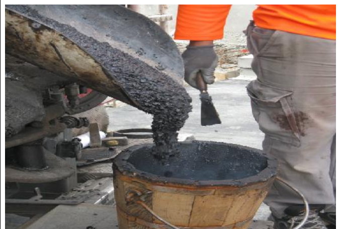
Il est transporté ensuite du camion jusqu'au poste de travail de l'asphalteur dans des seaux en bois prévus à cet effet
