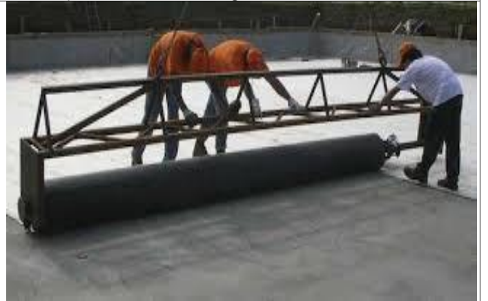
Pose de la membrane en EPDM à l'aide d'une grue et d'un dérouleur Le rouleau présente un grand poids et une grande longueur
