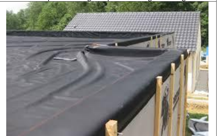
Toiture terrasse avec la membrane en EPDM, elle manque un peu d'étirage
