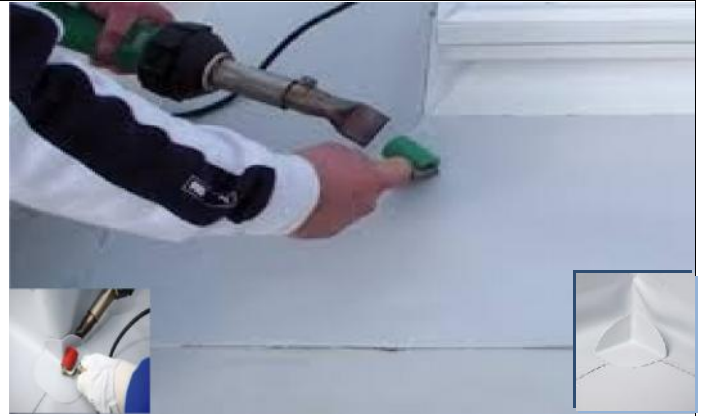
soudage des recouvrements à l'air chaud et par marouflage ainsi que le traitement des angles sortants et rentrants
